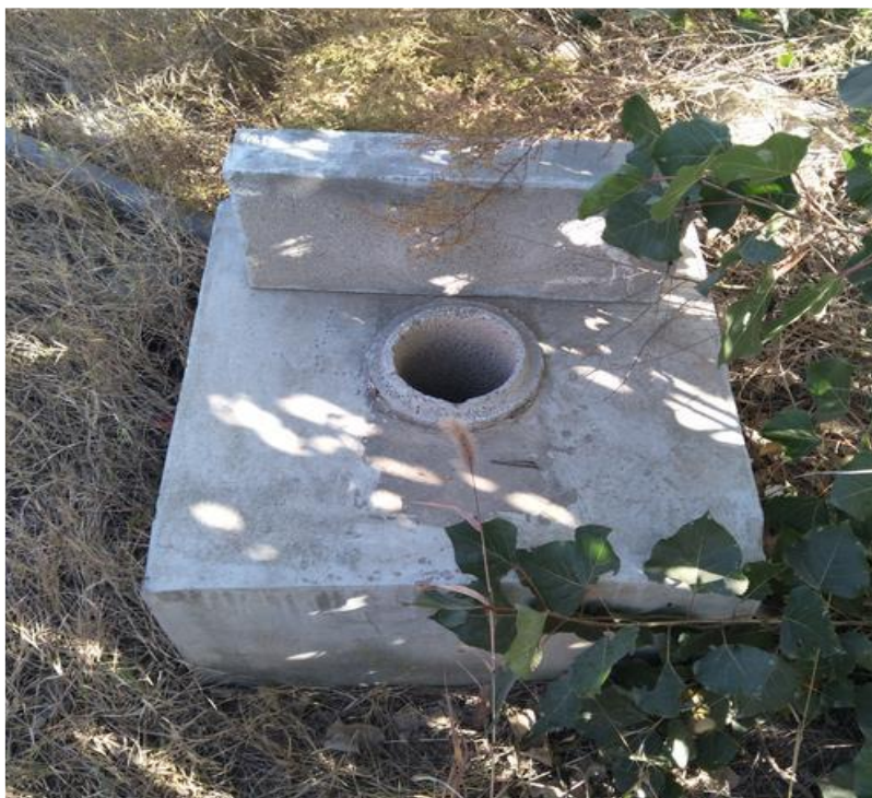
图 2-1-4 地下水监测井
