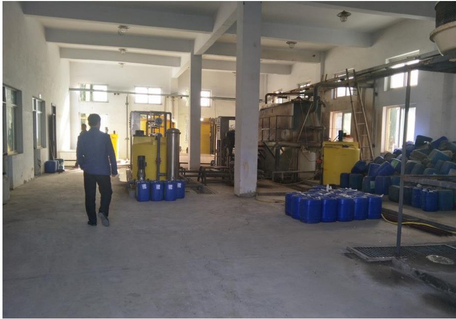
图 2-1-6 渗滤液处理车间
