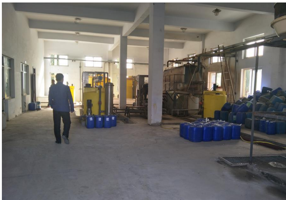
图 4-9 渗滤液处理车间
